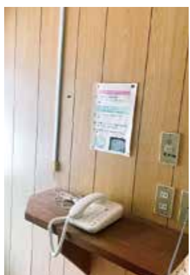
寺崎集落放送設備
